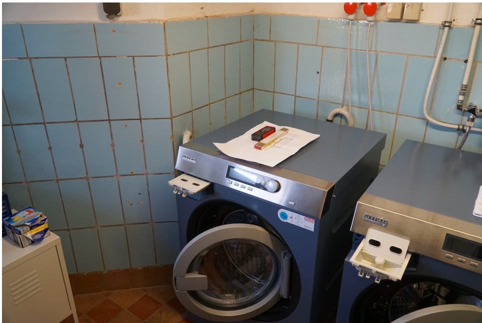
Fliesensockel / Waschmaschinen im Waschhaus
