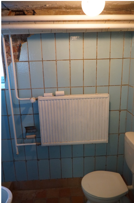
Heizkörper im Garten-WC
