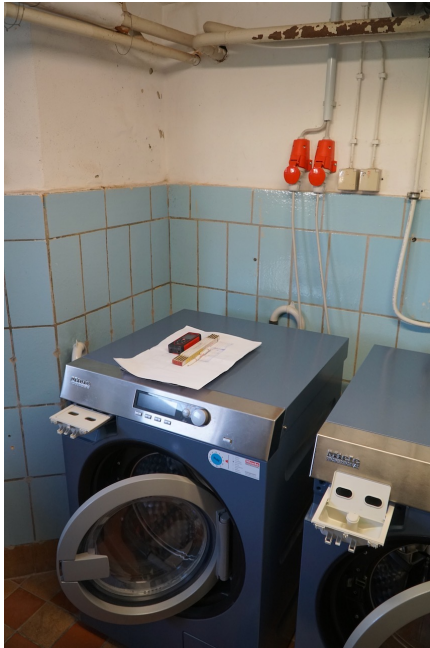
Fliesensockel / Waschmaschinen im Waschhaus
