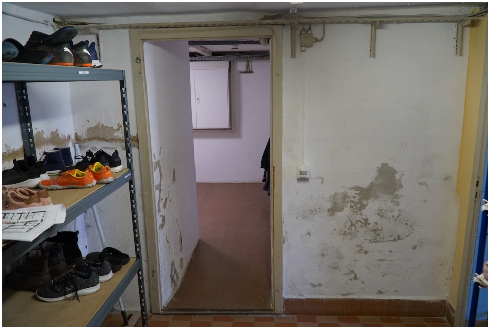
Ausblühungen im Putzbereich der Garderobe
