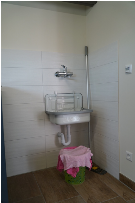
eues Ausgussbecken im Waschhaus
