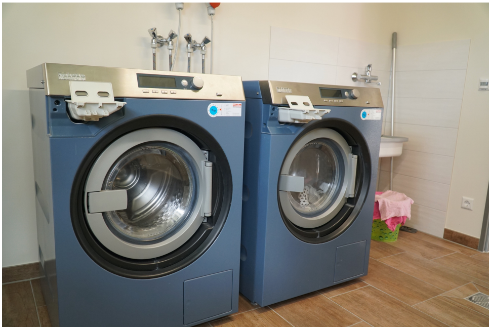
Waschmaschinen im Waschhaus mit Medienneuanchluss
